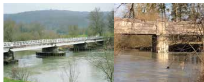
Ponts départementaux vers Tonnoy sur la RD 74 (à gauche) et à Lunéville sur la RD 31 (à droite) en mauvais état
